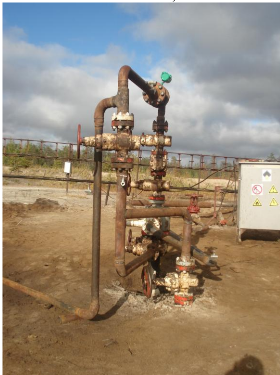
Рис. 4. Скважина для предварительного сброса воды в ООО «РН-Пурнефтегаз»
